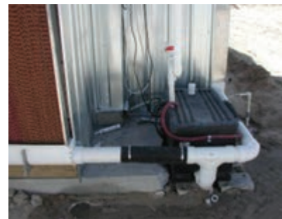
تصویر ۱۲-۲- پمپ و لوله های توزیع آب
